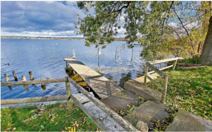
Die Seebadi Maur wird voraussichtlich erst 2028 anstatt wie ursprünglich vorgesehen in diesem Jahr saniert. Archivfoto: Ljilja Mucibabic
